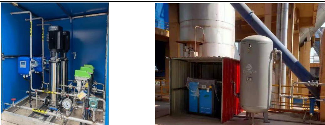
图 4 改造后现场照片（左一：输送+分配模块； 右一：压缩空气模块）
