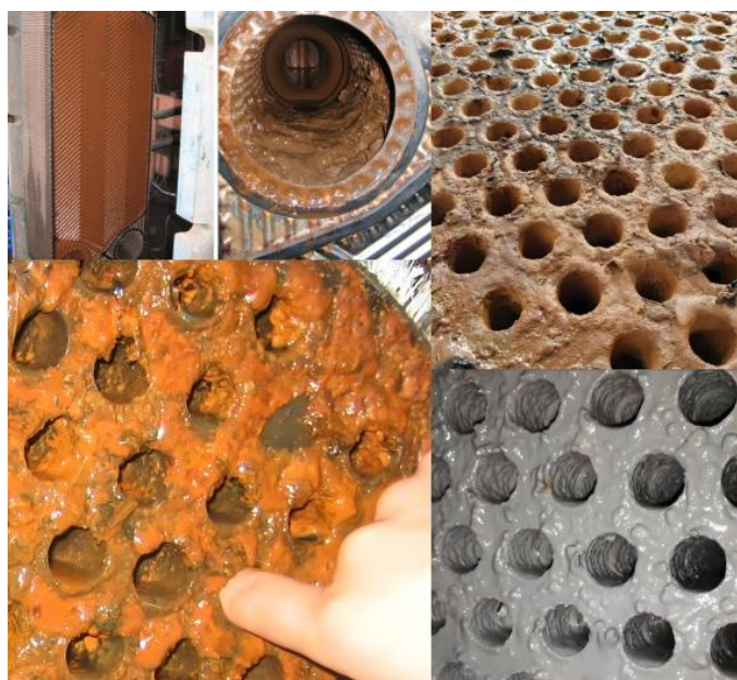
图 2 管道黏泥沉积现象
